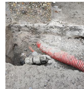
Réseaux non conformes aux règles de sécurité
